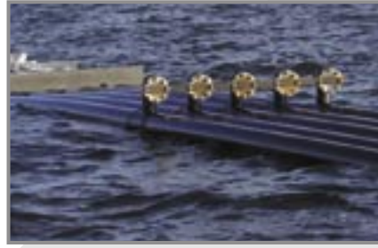
Præfabrikerede vandpåfyldningsanlæg monteret for altid at holde rørene vandfyldte
