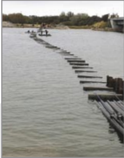
Her er den ene linie á 5 rørstrengte klar til at blive sænket ned på havbunden. 85 betonklodser á 800 kg er med til efterfølgende at holde rørene på plads.
